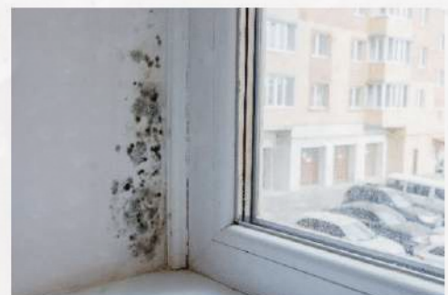
Ejemplo de humedad por condensación
