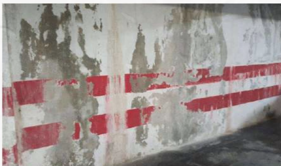
Ejemplo de humedad por filtración lateral
