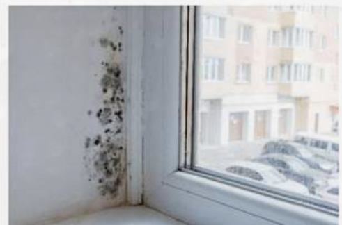
Ejemplo de humedad por condensación
