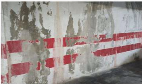
Ejemplo de humedad por filtración lateral
