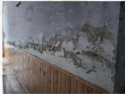
Ejemplo de humedad por capilaridad
